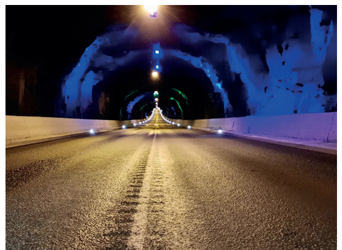
Tunnel lighting Nordoyatunnel Färøer
